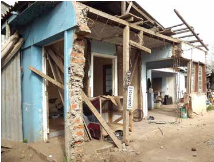
Figura 13. Vivienda de adobe con demolición incompleta en el barrio. Fuente: Archivo personal, 2012.
